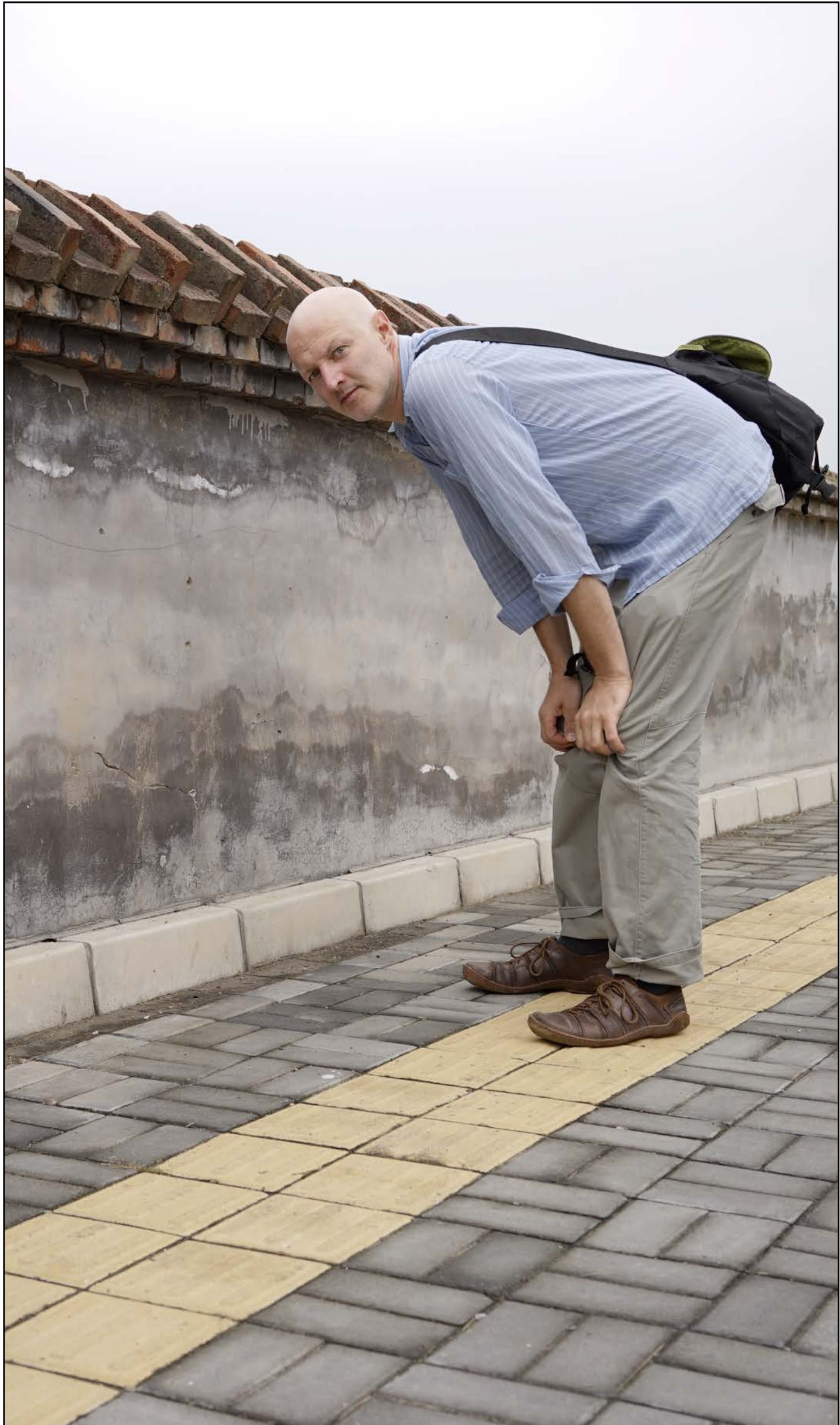
Ein Mauerwerk mit Ausblühungen.
